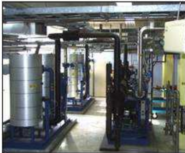
Salle de préparation pour l'ozone
