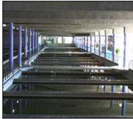
Salle de filtration d'eau
