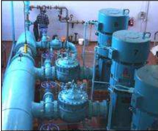
Salle de pompage eau traitée
