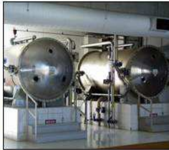
Salle de production d'air ozonée
